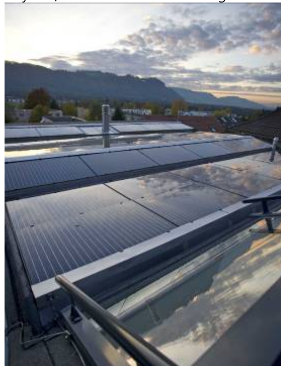
Im Dach vollflächig integrierte Solaranlage liefert die gesamte Energie, die das Haus benötigt - nämlich für die Wärmepumpen-Heizung, die Aufbereitung des Warmwassers und des Haushaltsstroms.
